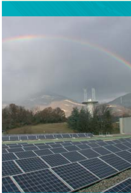
Centrale des Monts à Chambéry
