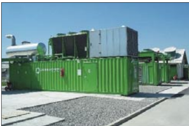
Plinski motorji na odlagališču odpadkov Ljubljana
