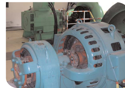
Installation de Valloire
