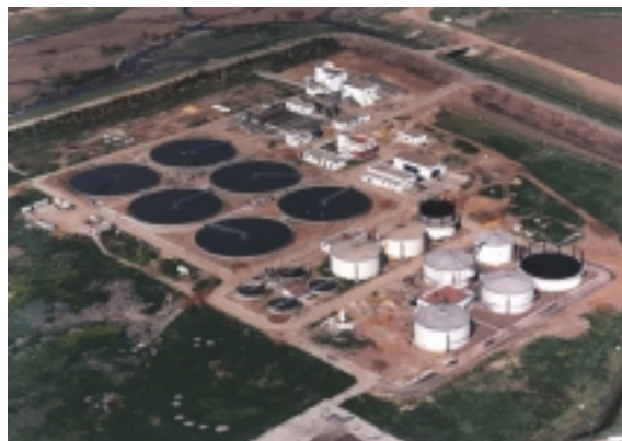
Estación Depuradora Copero, Sevilla
