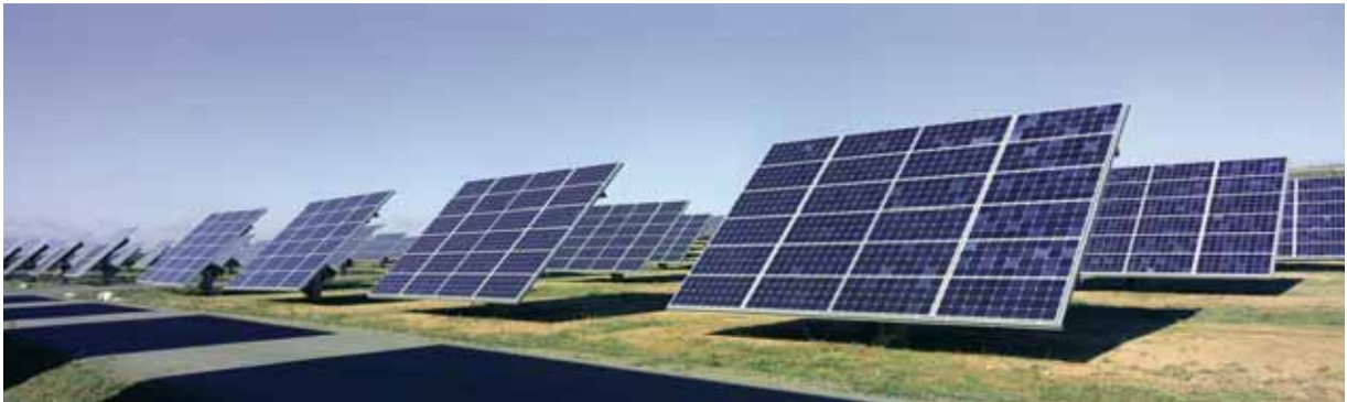
Parque solar fotovoltaico de Tudela
