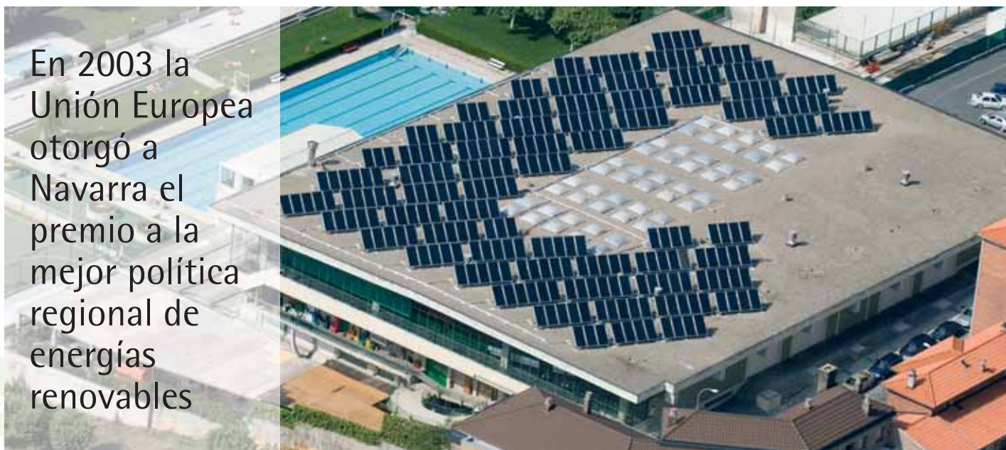
Paneles solares térmicos de las instalaciones de la Sociedad Deportiva Anaitasuna, en Pamplona
