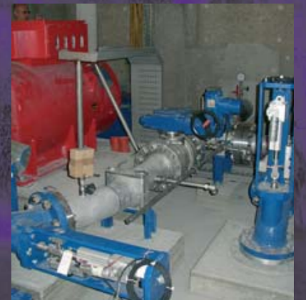
Installation de Valloire (Savoie)
