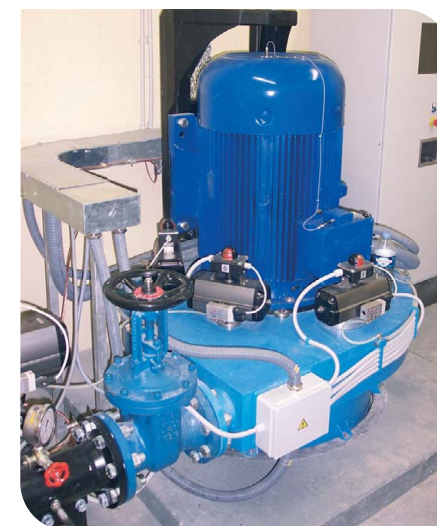
Installation de Saint Paul de Varcès
